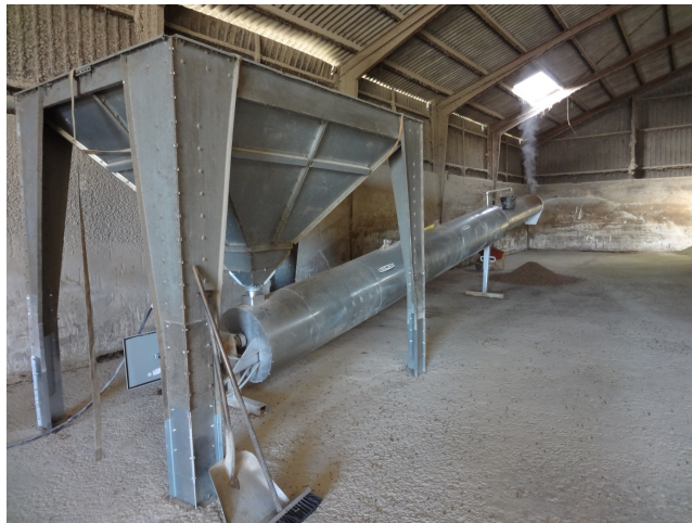
Toasteren består af en 11 meter langt rør, hvor der kører en snegl igennem. I røret er der ca. 400 liter olie, der varmes op ved hjælp af el. Selve toastningen foregår ved 120-140 grader og kapaciteten er ca. 3 ton pr døgn. Foto: Kirstine Jørgensen, Videncentret for Landbrug
